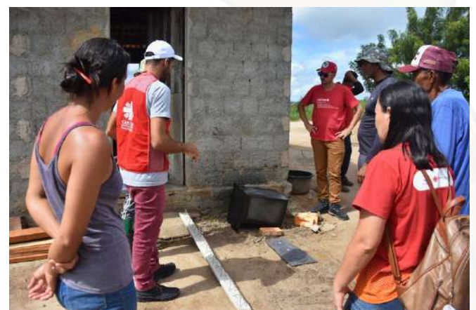
Figura 5 - Agentes Cáritas identificando local para construção do fogão ecológico, no Sítio de Lucicleide Gomes, na comunidade Sítio Fazenda Maria Morais, município de São Sebastião de Lagoa de Roça (PB)
