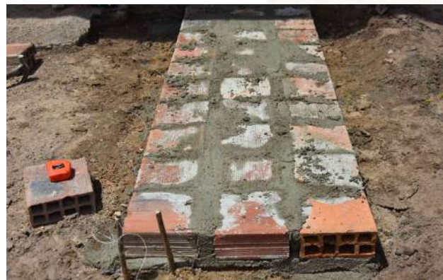
Figura 9 - Base do fogão ecológico concluída com tijolos cerâmicos de 8 furos e 10 cm acima do nível do solo
